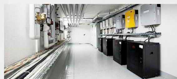
Ein gemeinsamer Technikkeller befindet sich unter den acht Häusern. Foto: Raab
