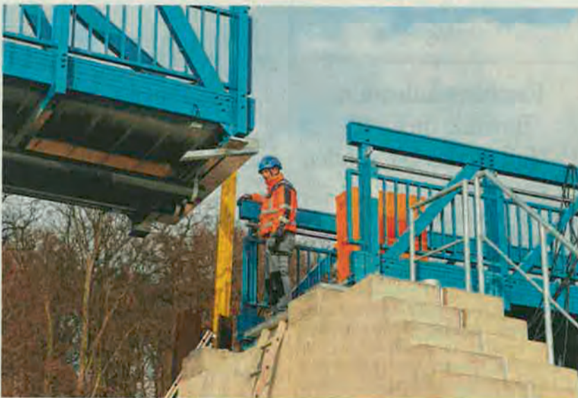
Ein Arbeiter auf dem bereits vor einigen Wochen verlegten ersten Brückenteil nimmt das zweite in Empfang.
