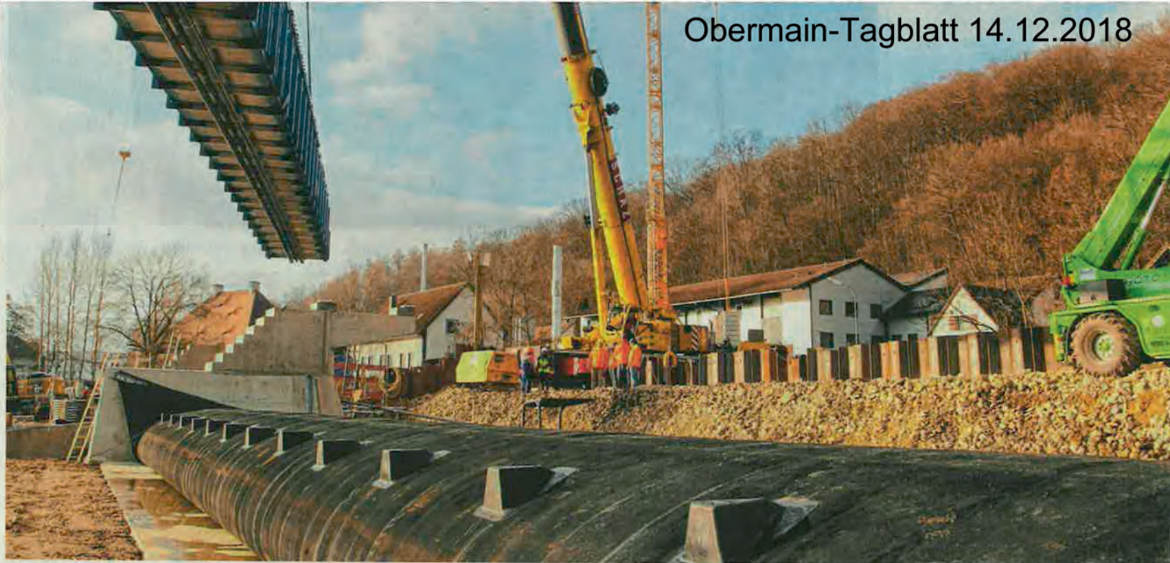
Das tonnenschwere Brückenteil schwebt über dem Schlauchwehr 2 des Wasserkraftwerks Hausen. Betreiber ist die SÜC Energie und H2O GmbH. FOTOS: MARKUS DROSSEL
