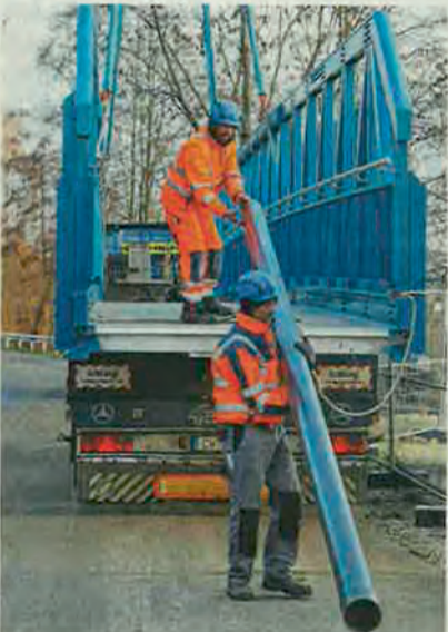
In den Rohren, die alsbald unter der Brücke montiert wurden, verlaufen die Versorgungsleitungen für die LED-Beleuchtung.
